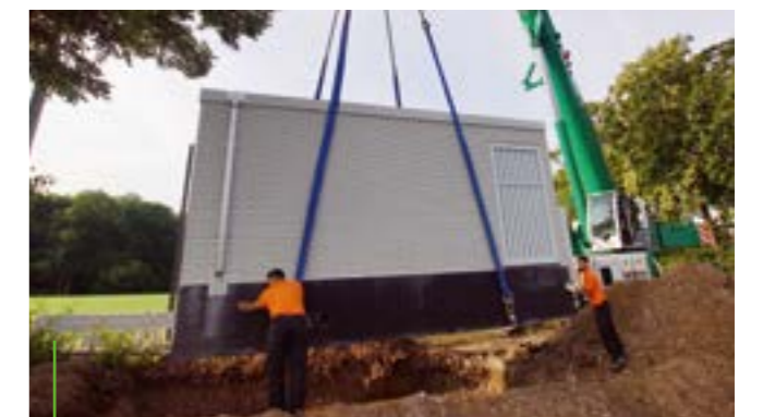
Ein Glasfaser-Hauptverteiler wurde im Sommer 2023 an der Kilverstraße in Bruchmühlen aufgestellt.
