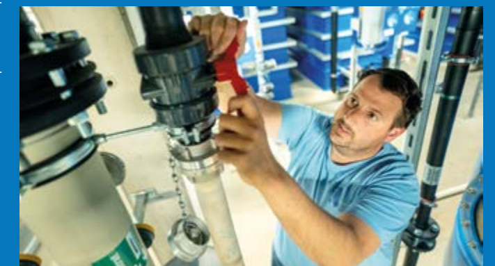
Zwei Handgriffe von Eike Henke sind notwendig, dann fließt das Wasser direkt aus dem Keller ins Kombibecken.
